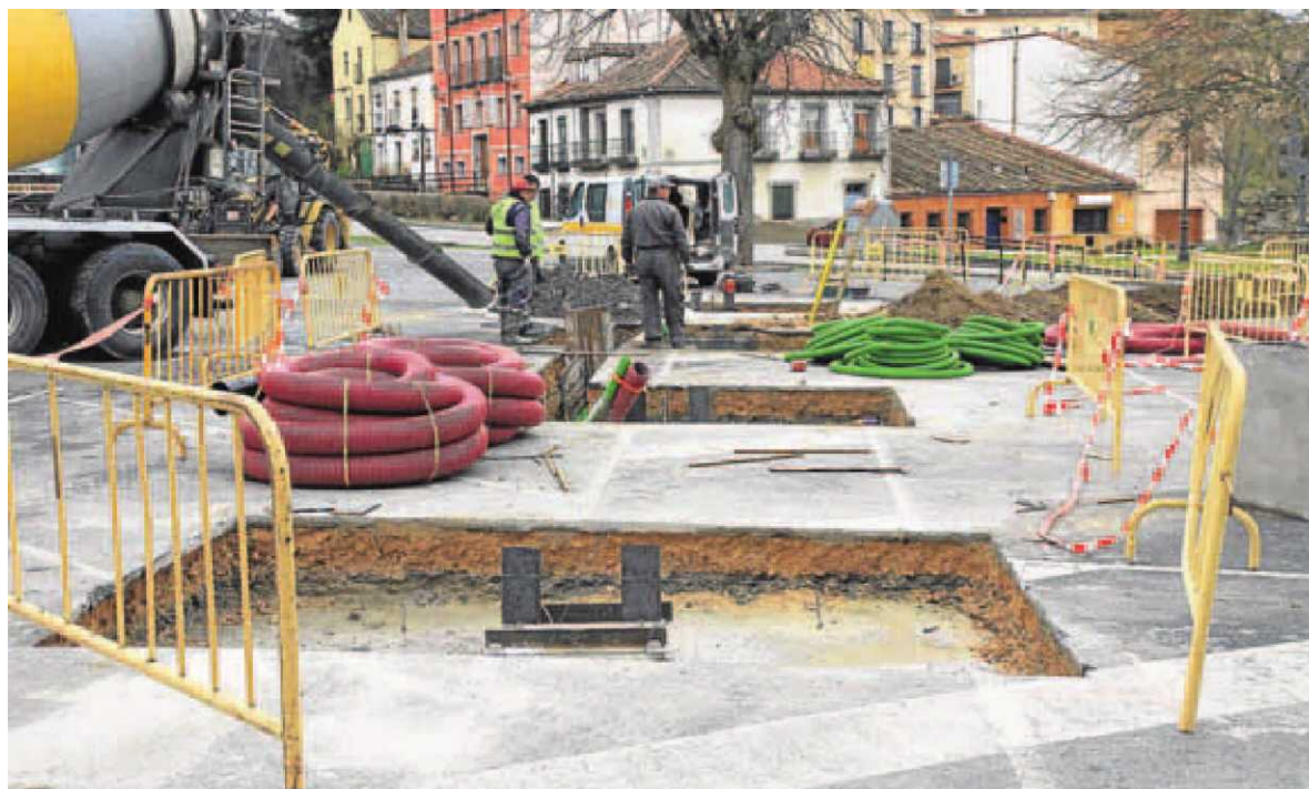
Obras para la instalación de la electrolinera, que se ubicará en la parte central del aparcamiento de Puerta de la Reina. :: ANTONIO TANARRO
